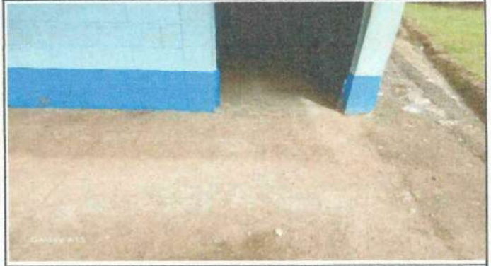
Foto 2 FOTOGRAFIA DEL MODULO NO. 4, PISO DE CONCRETO DE DIRECCION CON DETERIORO Y GRIETAS.
