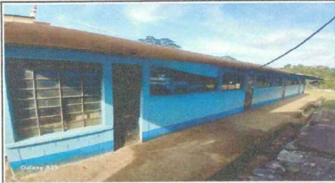
Foto 1 FOTOGRAFIA DEL MODULO NO. 4 PISO. PISO DE CONCRETO EN MAL ESTADO.
