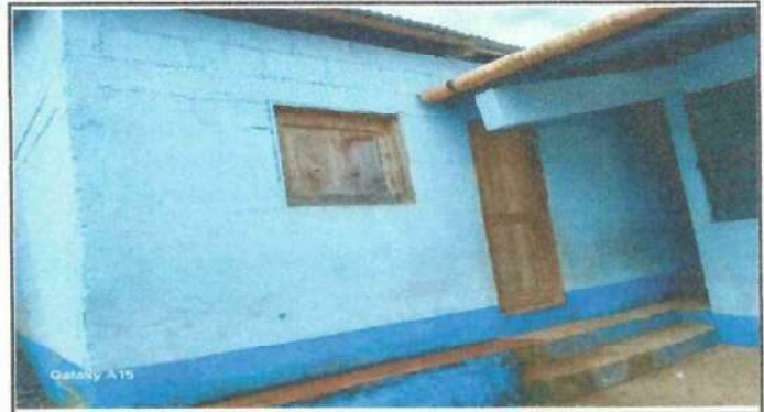
Foto 4 MÓDULO 1, PUERTAS Y VENTANAS CON HUMEDAD.
